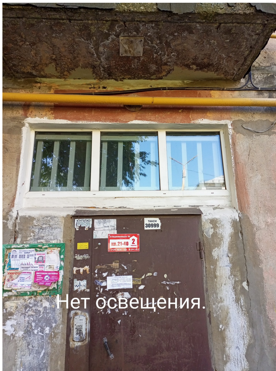
Рисунок 6 – Отсутствие освещения над входом в подъезд
